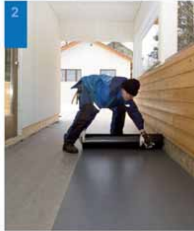
2. Alustan päälle on asennettu suodatinkangas laakerointikerrokseksi, jonka päälle asennetaan Protan SE 1,6 mm vedeneriste.
